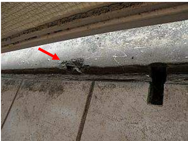
poškozená část stropního panelu s viditelnou výztuží
