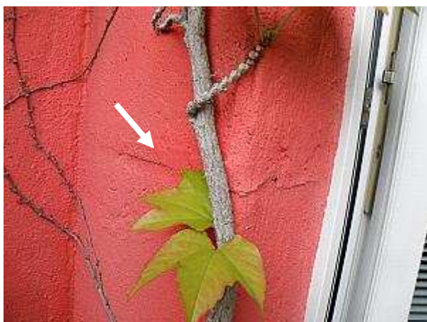
prasklina mezi panely
