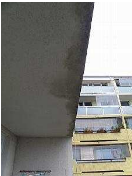
spodní hrana lodžiového panelu bez okapové hrany je vystavena vlhkostnímu namáhání při deštích
