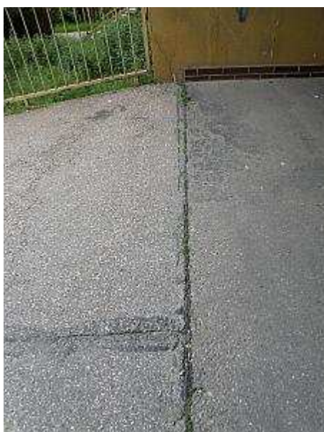
prasklina v dilataci
