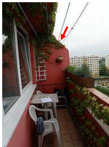
chybějící oplechování u šikmých dělicích stěn lodžii
