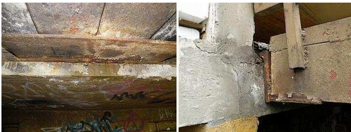
Poškozená ocelová nosná konstrukce vlivem zatékání
